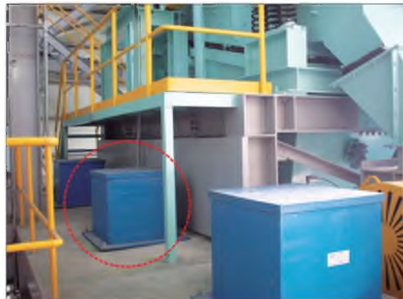
① 발전소 바닥 진동 제어(Dynamic Absorber)
